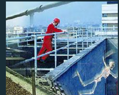
Edge Protection railings
